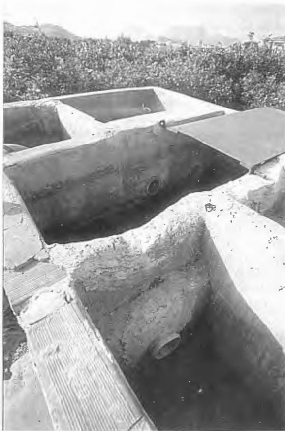
Fig. 5 Sistema di vasche di distribuzione dell'acqua sulla sommità di un «castelletto» secondario servito da una moderna condotta a pressione. Le foto sono dell'Autore.
