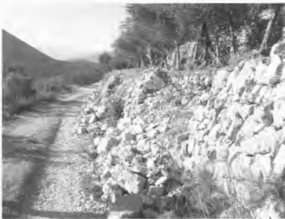
Fig. 9. Esempi di cattiva manutenzione e degrado del paesaggio terrazzato a Vallecorse.
