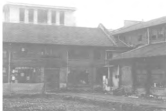
Fig. 4.1 - Lato interno dell'edificio prospiciente via Messina non ancora coinvolto dai lavori di ristrutturazione.
